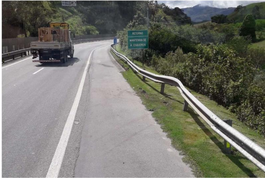
FOTO 05 – Dispositivo de Segurança - Km 7+700 Norte [1]
