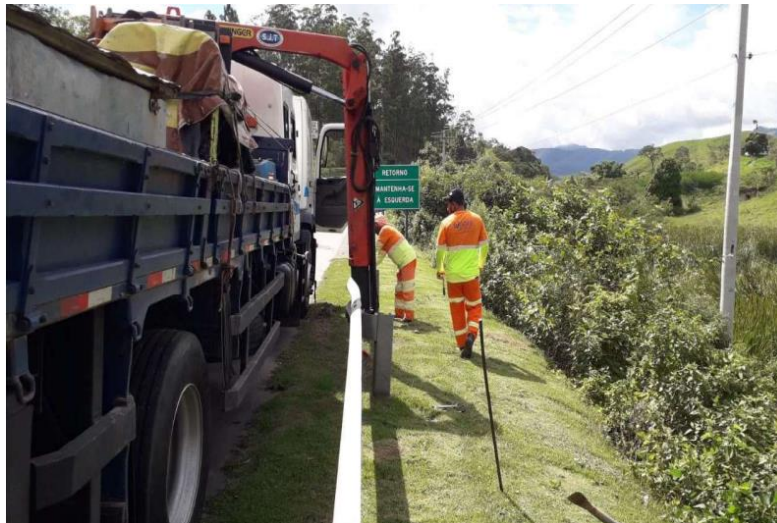
FOTO 06 – Dispositivo de Segurança - Km 7+700 Norte [2]
